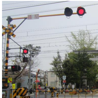
オーバーハング型踏切警報機
