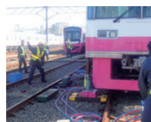
脱線復旧(旧新京成電鉄)
