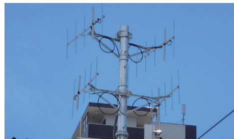
地上基地局アンテナ
