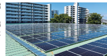
設置した太陽光パネル(店舗屋根上)
