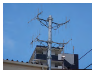
地上基地局 アンテナ
