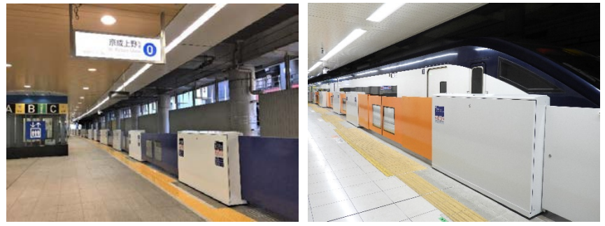
ホームドア (写真は日暮里駅・空港第2ビル駅)
