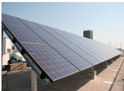
施設屋上に設置された太陽光パネル
