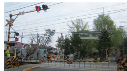
オーバーハング型踏切警報機
