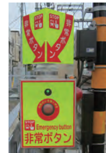
押ボタン式踏切支障報知装置
