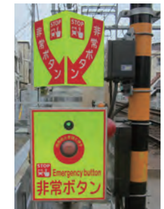
押ボタン式踏切支障報知装置
