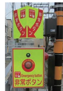
押ボタン式踏切支障報知装置
