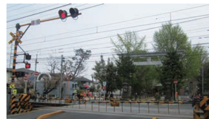
オーバーハング型踏切警報機
